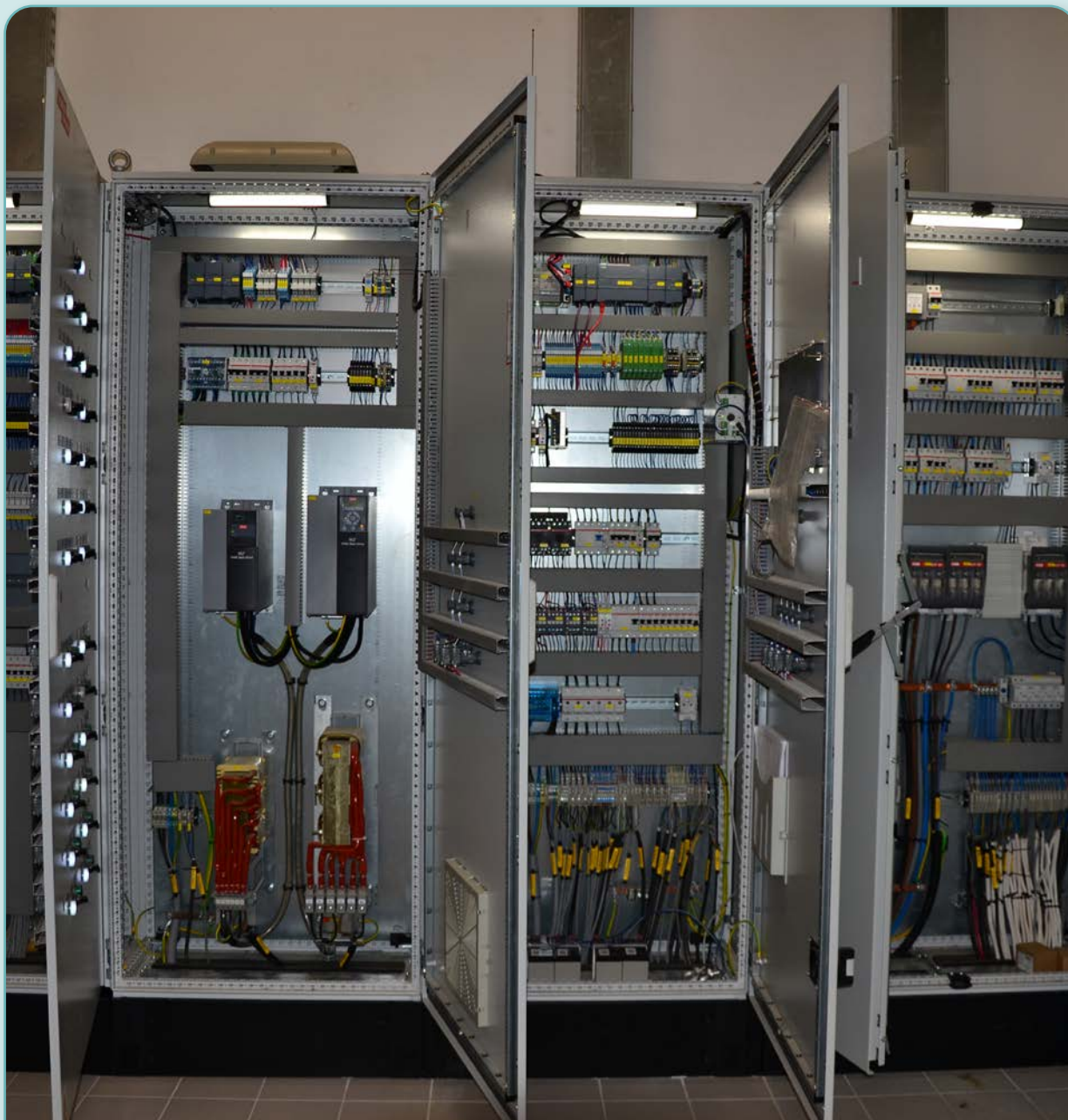
Technologia uzdatniania wody na Stacji Uzdatniania Wody w Brąszewicach
