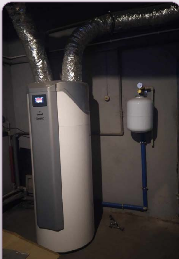
Pompa ciepła zamontowana w ramach projektu „Poprawa jakości powietrza poprzez zwiększenie udziału OZE w wytwarzaniu energii na terenie Gminy Brąszewice”
