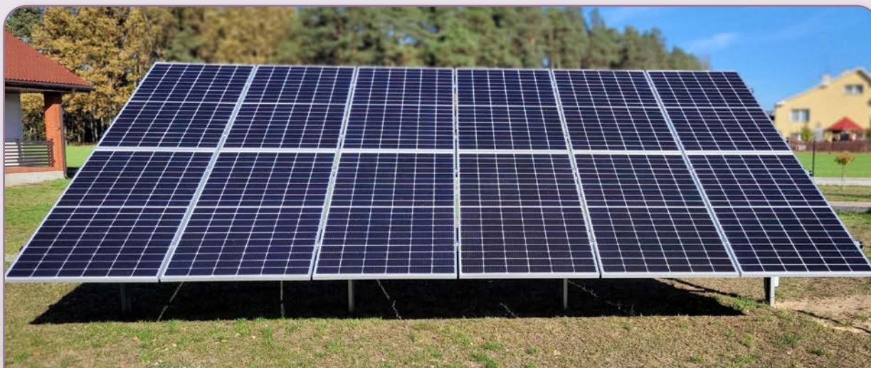
Instalacja fotowoltaiczna zamontowana w ramach projektu „Poprawa jakości powietrza poprzez zwiększenie udziału OZE w wytwarzaniu energii na terenie Gminy Brąszewice”
