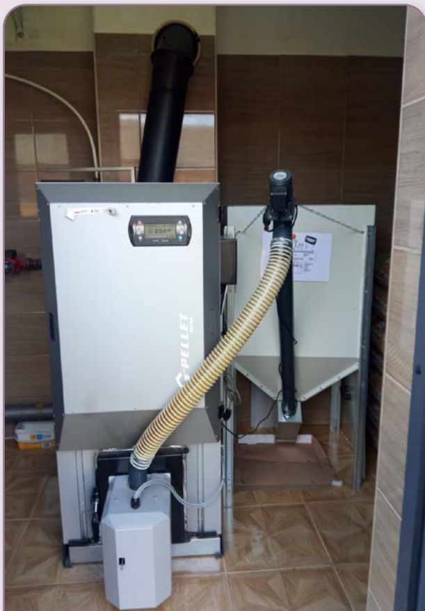
Kocioł na biomasę zamontowany w ramach projektu „Poprawa jakości powietrza poprzez zwiększenie udziału OZE w wytwarzaniu energii na terenie Gminy Brąszewice”
